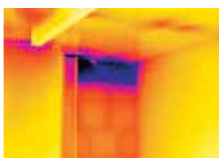
Обнаружение и визуализация повреждений вызванных влажностью в ограждающих конструкциях
