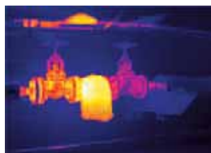
Проверка функциональности паропроводящих труб
